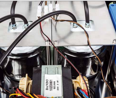
„Marmeladengläser“ fungieren in der Steuereinheit als Druckluft-Zwischenspeicher
